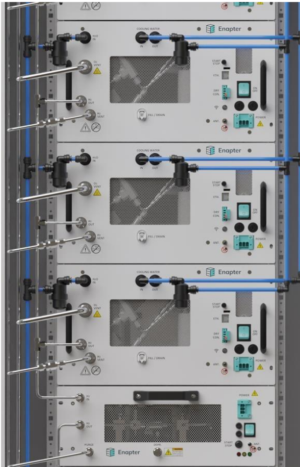
Trois EL4.1 et un DR2.1 avec des tuyaux de refroidissement communs <5>
